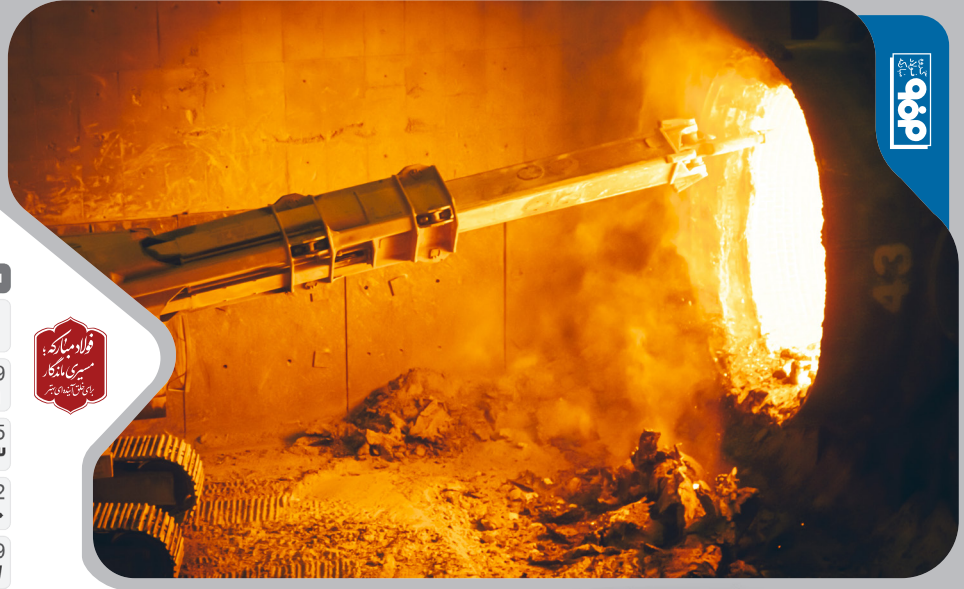
ناحیه فولادسازی و ریخته‌گری مداوم - لبه کنی ضایعات پاتیل مذاب جهت آماده سازی پاتیل
